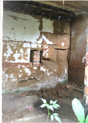
破落的内间夯土墙
