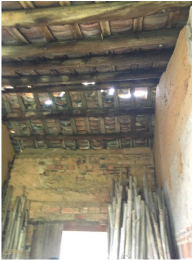
残缺的门厅屋顶
